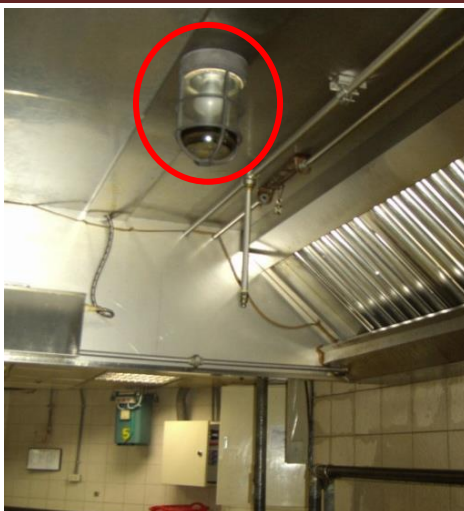
圖 2.3.2 排煙罩照明耐高溫玻璃罩
