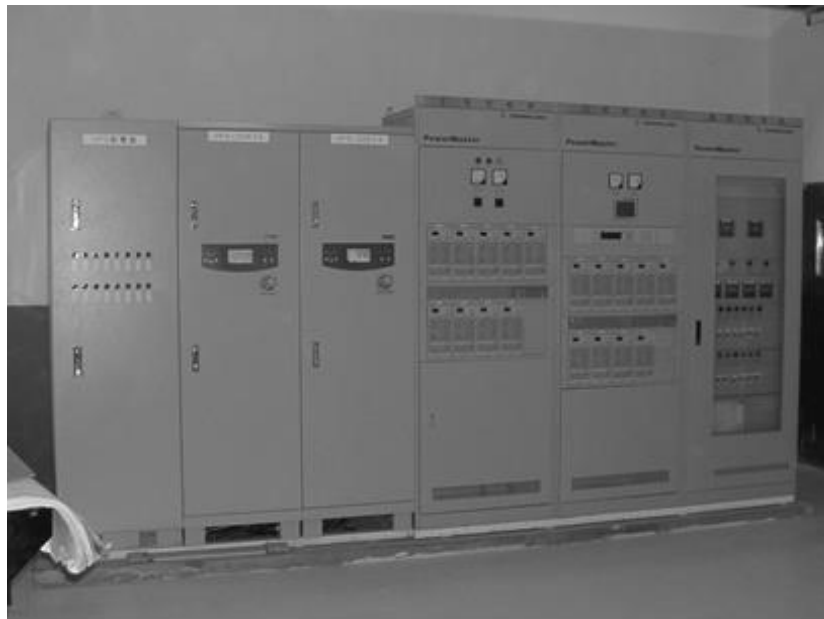
圖 2.3.3 UPS 系統安裝實例 (銘板製作標準採反刻白底綠字)
