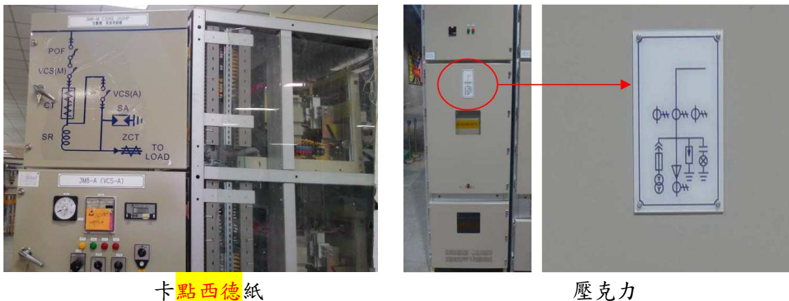
圖 2-6 高壓盤盤面張貼單線圖
